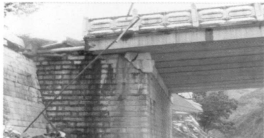
图 6 龙尾大桥桥台胸墙破坏
