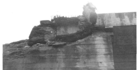
图 5 高原大桥桥台胸墙破坏
