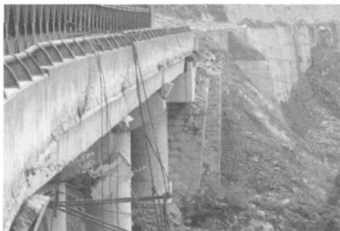
(a) 挡块冲切破坏
