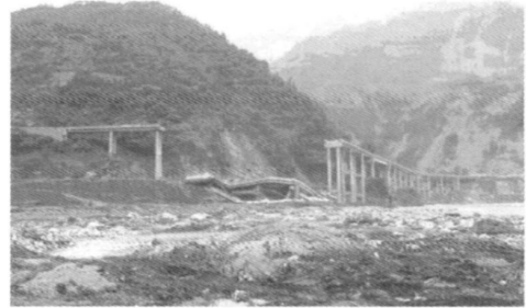
图 11 百花大桥震害(曲线桥)
