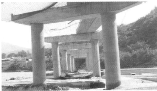
图 10 南坝大桥落梁(斜交桥)
