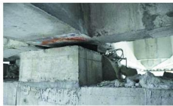
(e) 引桥支座移位及挡块损坏
