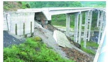
(c) 台后填土滑坡但桥台整体稳定
