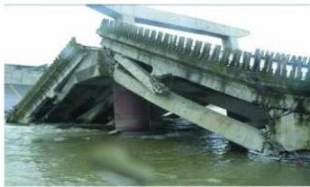
(d) 桥墩倾斜, 基础破坏
