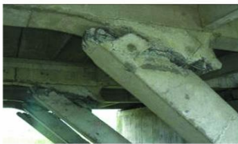
(g) 腹杆顶部节点剪切破坏 (北侧第1跨)
