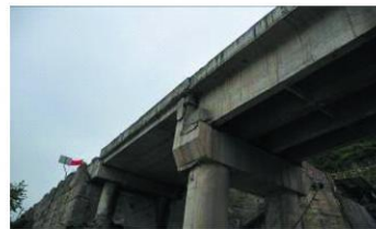
(k) 庙子坪大桥上 213 国道跨线桥震害
