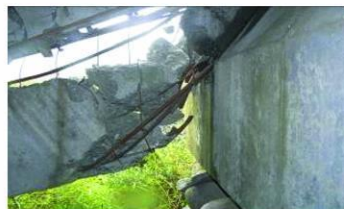
(j) 拱圈(肋)的剪切及黏结破坏 (南侧第2跨倒塌)
