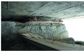
(d) 主桥支座及垫块损坏图
