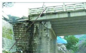
(j) 桥台破坏情况
