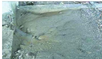
(b) 龙尾大桥桥墩液化 (考虑泄洪推断为余震液化)
