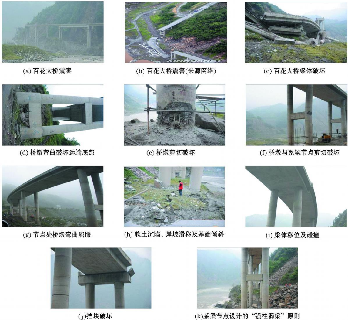
图 2 百花大桥震害 Fig 2 Damage to Baihua Bridge
