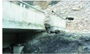
(b) 主梁在桥台处移位
