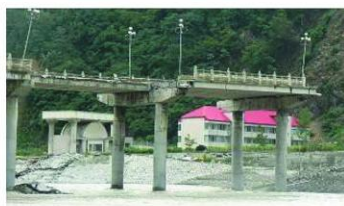
(h) 桥墩顶部横向弯曲塑性铰 (最右侧桥墩)
