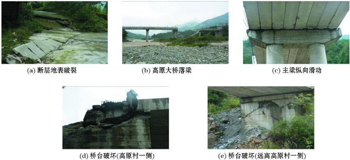
图 7 高原大桥震害
