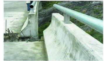
(c) 主梁伸缩缝处横向错位
