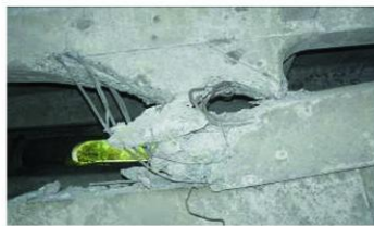
(h) 腹杆顶部节点剪切破坏 (南侧第2跨倒塌)
