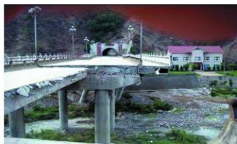
(f) 第7跨桥墩倾斜接近倒塌 (近端第2跨墩底可见喷砂现象)
