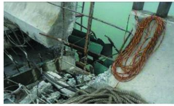
(b) 庙子坪大桥主桥与引桥错位
