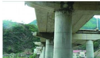
(c) 主梁横向移位, 挡块撞碎
