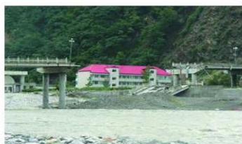
(g) 第7跨桥墩冲毁 (唐家山泄后即目前所见情况)
