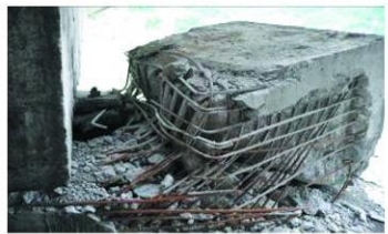
(f) 主桥挡块破坏, 缓冲垫脱落
