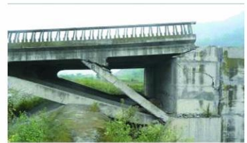
(f) 北侧第1跨肋拱、腹杆剪切破坏
