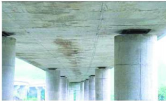
(a) 新房子大桥支座损坏
