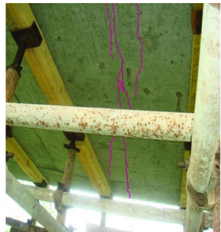
图 5 A 匝道桥 5 号墩上部箱梁横向断裂
