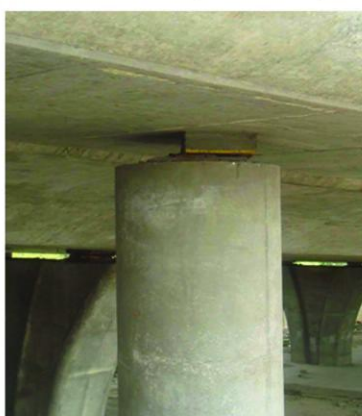
橡胶支座滑移(C匝道10号墩)
