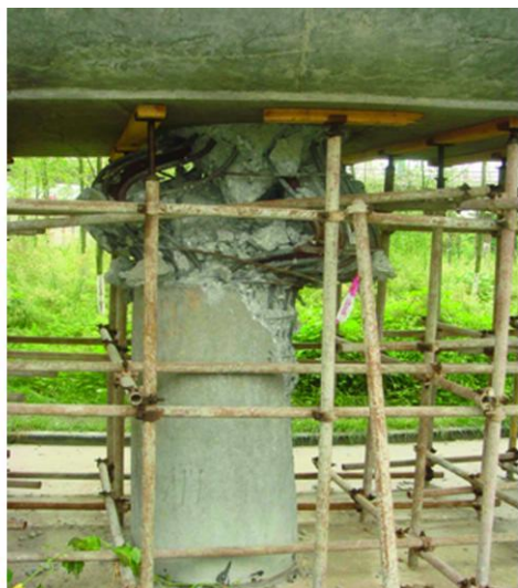
图 6 C匝道桥 2号墩破坏
