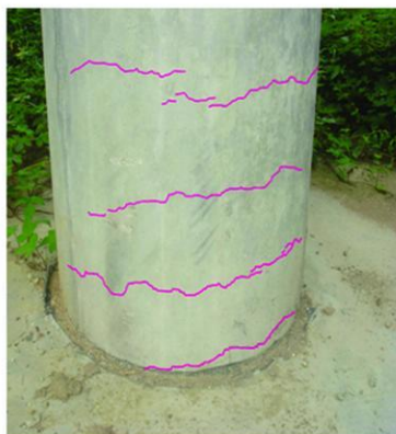
水平弯曲开裂(D匝道德号墩)
