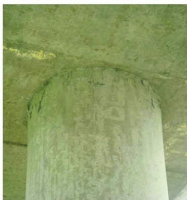
混凝土保护层脱落(C匝道4号墩)
