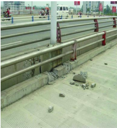
主桥与匝道桥横向碰撞-A匝道
