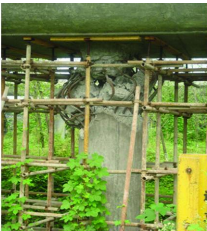
图 4 A 匝道桥 5 号墩破坏
