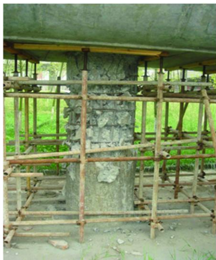
图 8 D匝道桥 2号墩破坏
