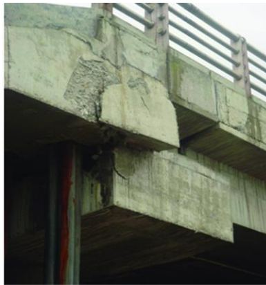
梁与挡块的碰撞破坏-A匝道
