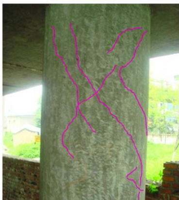
剪切斜裂缝(B匝道3号墩)
