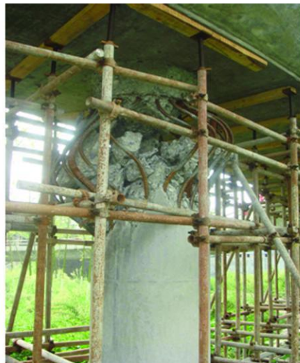
图 9 D匝道桥 4号墩破坏
